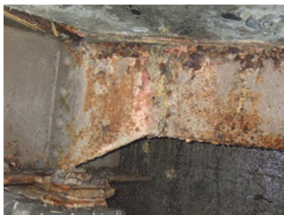
(a) 腐食が著しい事例
