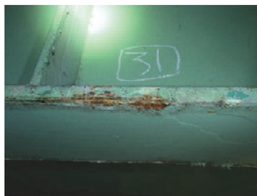
(b) 下フランジの腐食状況
