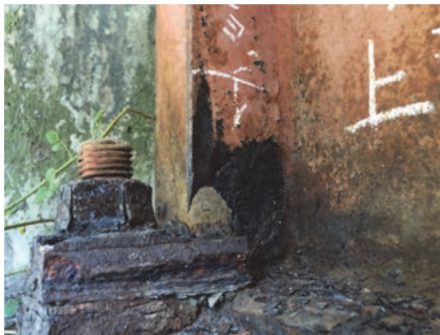
写真 5.2.1 鋼桁端部の腐食による断面欠損の一例
