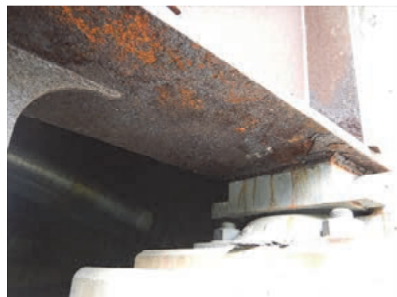
(b) 桁端近傍の下フランジ下面の腐食状況
