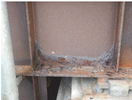
(a) 桁端の腐食状況
