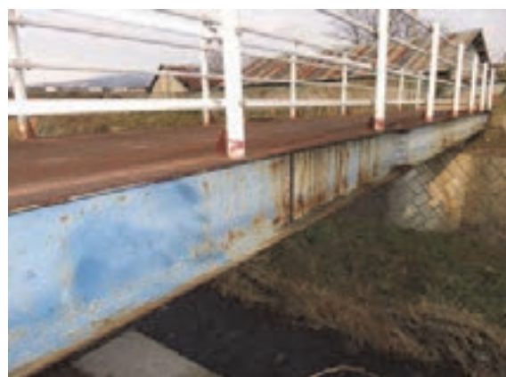
(b) 腐食が一様な事例
