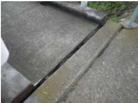
<伸縮装置目地材の欠損>
