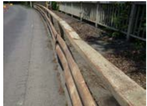
<防護柵の変形>
