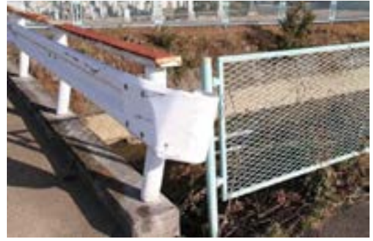
<防護柵の変形>
