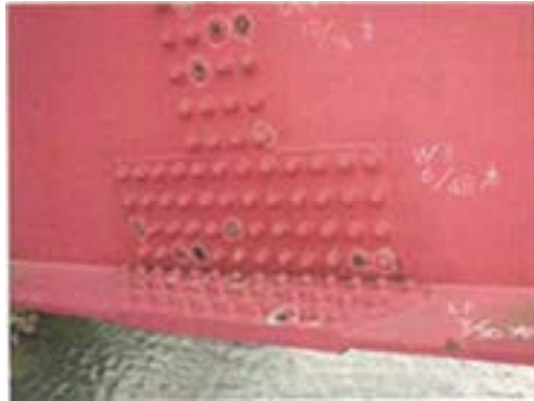
写真 1.6.7 ボルトの破断 9)
