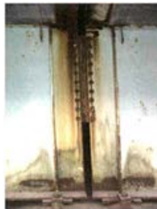
写真 1.6.2 橋脚部の漏水による腐食 7)
