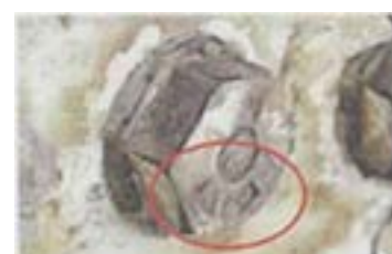
写真 1.6.6 ボルトのさび 9)
