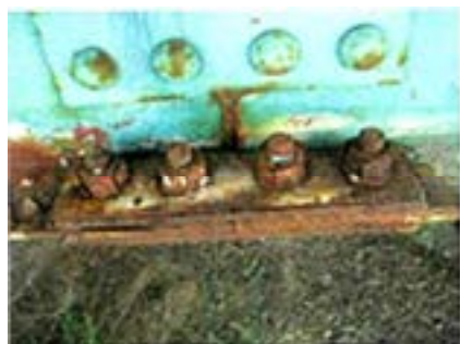
(a) 添接部全体の腐食
