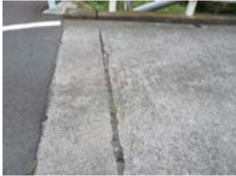
<伸縮装置目地材の欠損>
