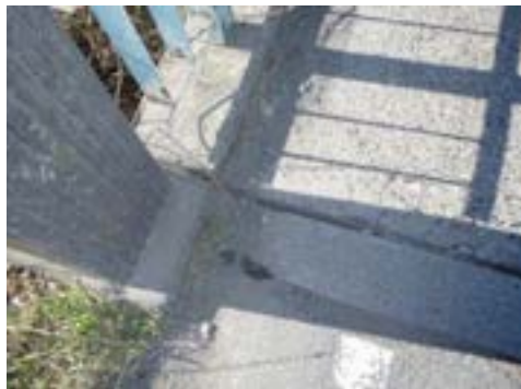
<伸縮装置目地材の抜け落ち>
