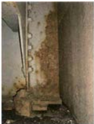
写真 1.6.1 橋台部の漏水による腐食 7)
