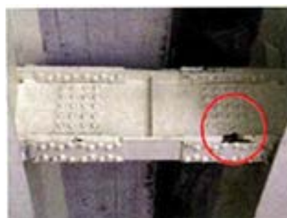
(b) 添接板のすき間腐食
