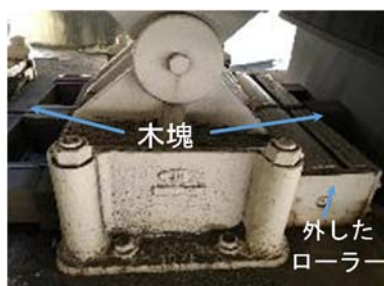
図 5-2-2. 補修した脱落鋼製支承
