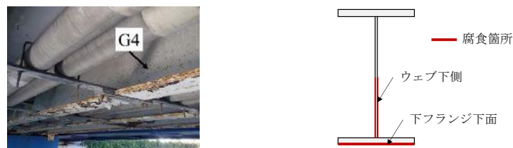
(a) G4 桁のウェブ下側・下フランジ下面での腐食とモデル主桁断面での減厚箇所
