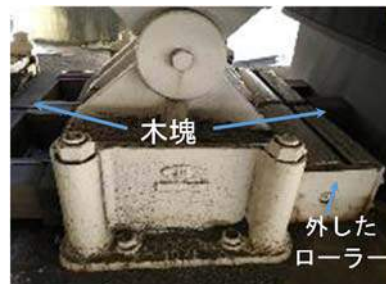
図 5-2-2. 補修した脱落鋼製支承
