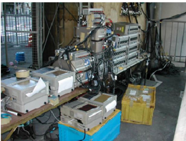
(a) 設置状況全景
