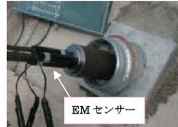
図 2-8 EM センサ設置状況 2)
