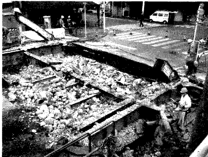
[写真-4.23：床版が破砕された橋端部]
